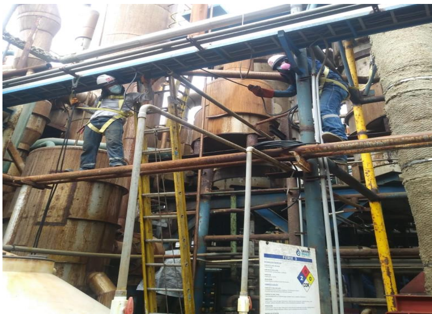
Recorrido de cable eléctrico
