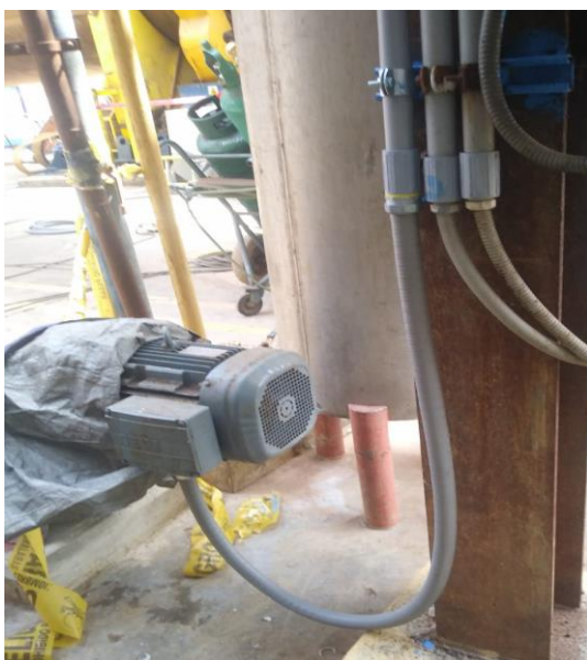
Canalización de la bandeja hasta el motor
