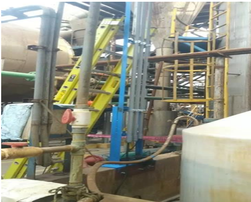
Tendido de tubería PVC-SAP de 1" y \frac{3}{4} " hacia el soporte del tablero eléctrico.
