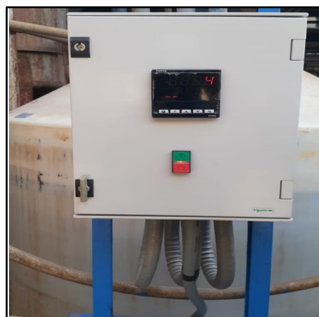
Figura 8. Instalación de tablero eléctrico para el control de bomba de lodo en funcionamiento Fuente: (Elaboración propia)
