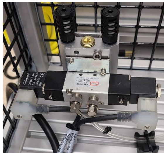
(d) pneumatic valves
