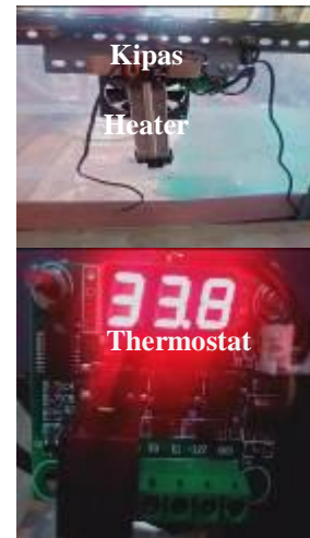
Gambar 14 Implementasi sistem di ruang pengering
