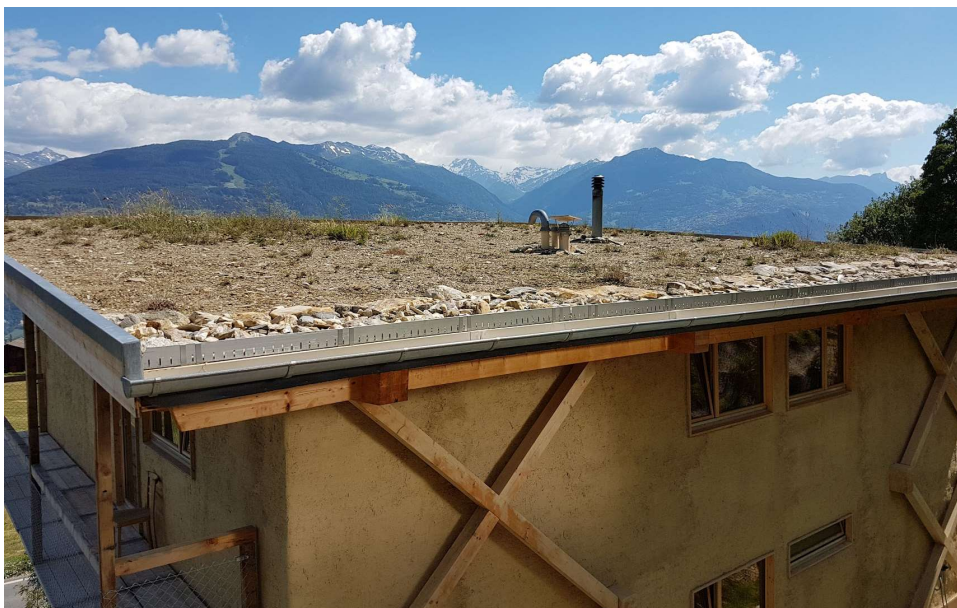
Abbildung 30: Dachbegrünung unter extremen klimatischen Bedingungen © Nathalie Baumann
