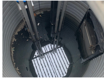
(d) Pumps sitting in a wet pit (Ishøj, Denmark).
