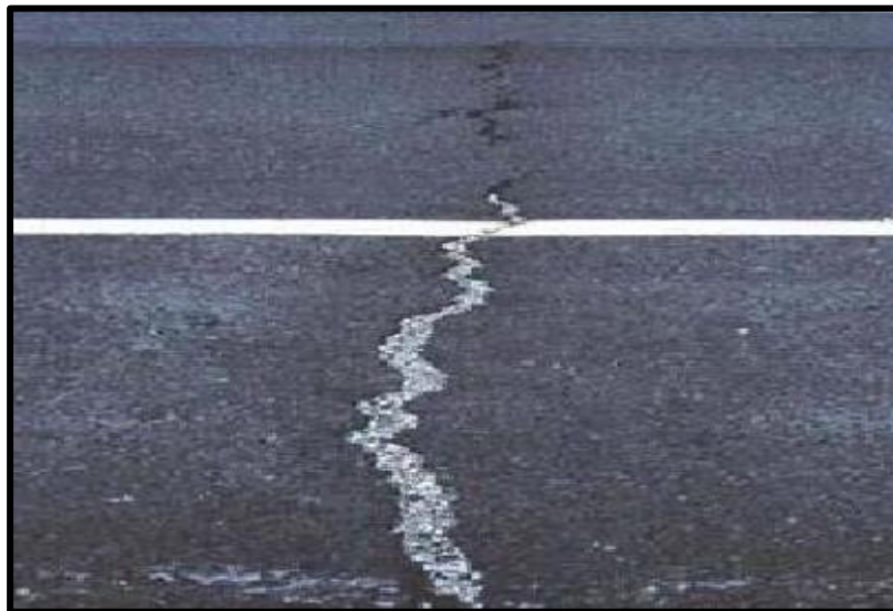
Nivel de severidad H (High:alto)
