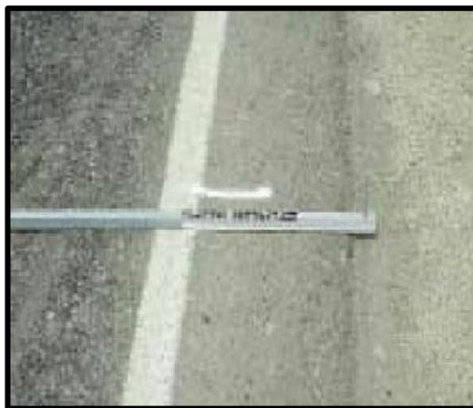
Nivel de severidad L (Low:bajo)
