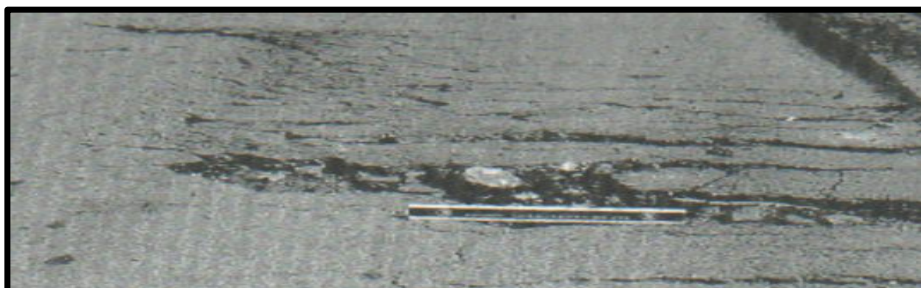
Nivel de severidad H (High:alto)
