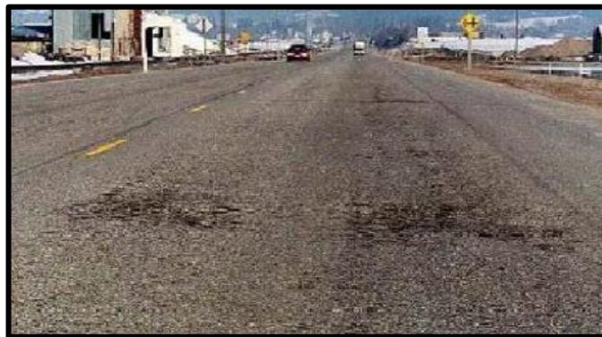
Nivel de severidad H (High:alto)
