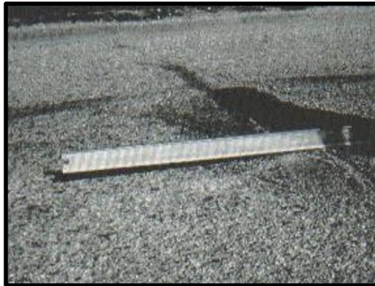
Se observa el nivel de severidad L (Low - bajo)
