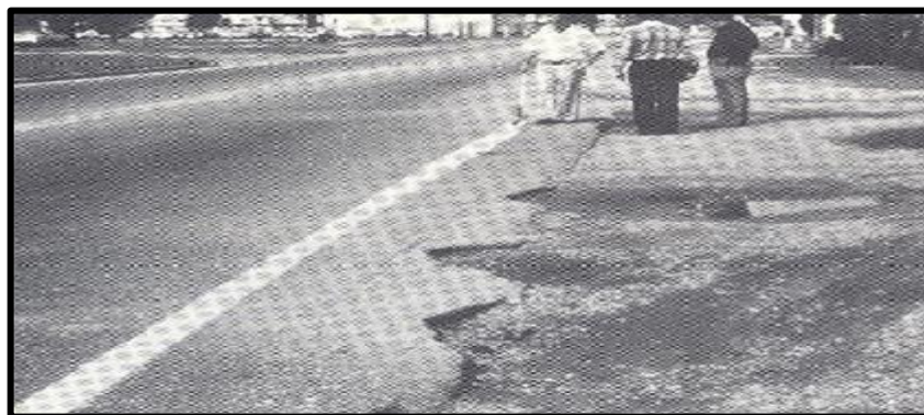
Nivel de severidad H (High-alto)
