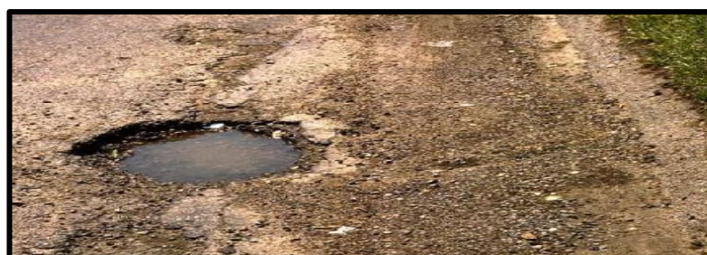
Nivel de severidad H (High-alto)
