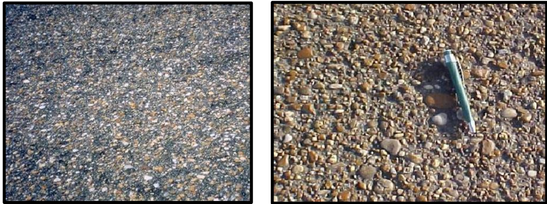
Nivel de severidad L (Low:bajo) Nivel de severidad M (Medium:medio)
