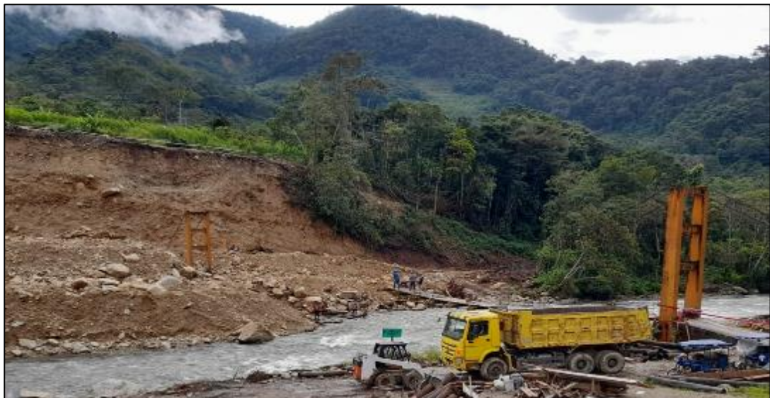
30 DE ABRIL DEL 2021: Se observa los trabajos de desmontaje de puente peatonal existente.
