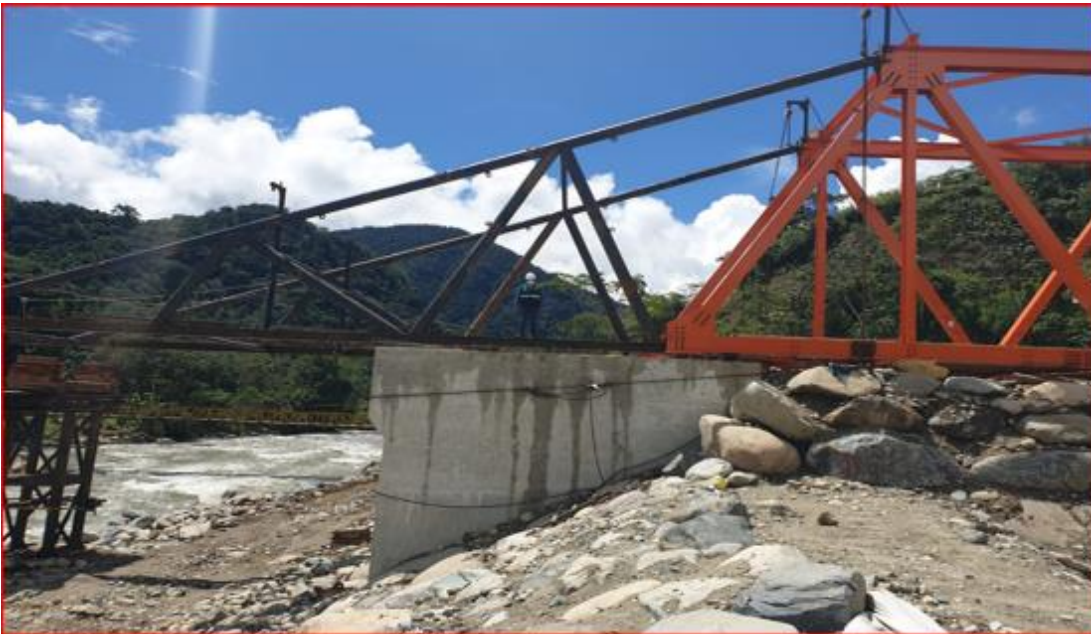
08 DE ABRIL DEL 2021: Se observa los trabajos de fabricación y colocado de nariz de lanzamiento, de acuerdo a lo que nos menciona el plan de montaje y lanzamiento
