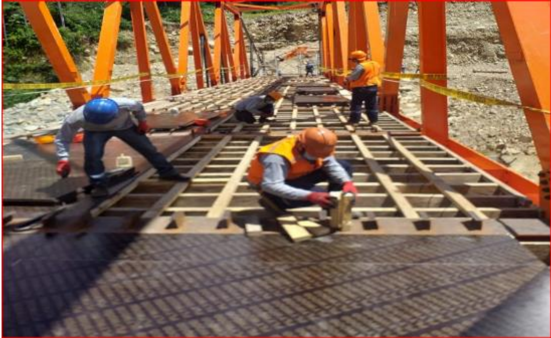
23 DE ABRIL DEL 2021: Se observa los trabajos de colocación de triplay 18mm en losa, como parte de los trabajos de encofrado en losa de puente vehicular.
