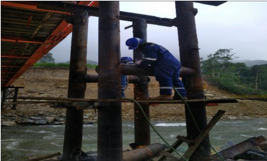
23 DE ABRIL DEL 2021: Se observa los trabajos de desmontaje de torres metálicas.
