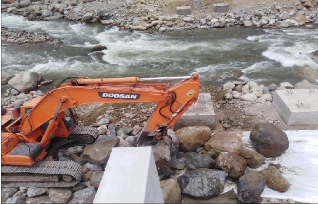
15 DE FEBRERO DEL 2021: Se realiza los trabajos de colocado de rocas en cimentación de enrocado, al margen derecho del rio Tocache.
