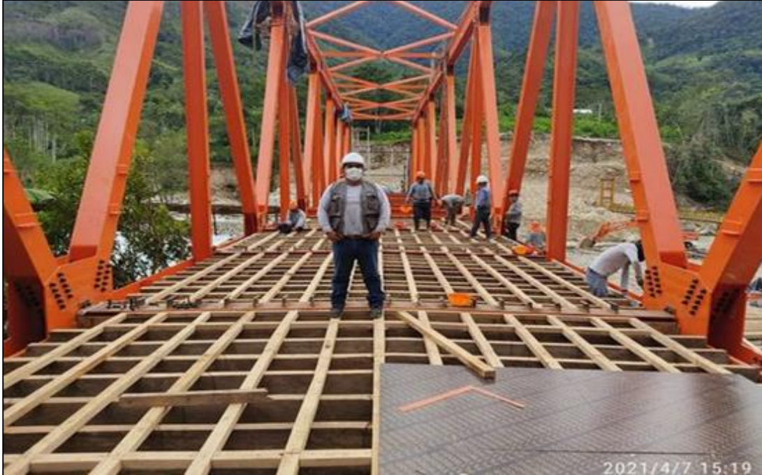
07 DE ABRIL DEL 2021: Se observa los trabajos de encofrado de losa de puente vehicular.
