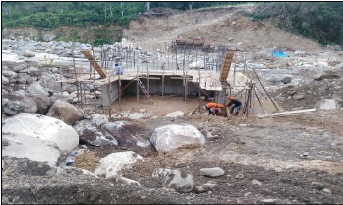
28 DE NOVIEMBRE DEL 2020: Se realiza los trabajos de colocados de concreto F'C= 210 \text{ kg/cm}^2 en pantalla de estribo derecho SEGUNDO NIVEL.
