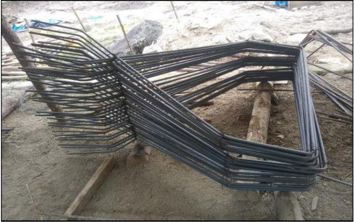
12 DE DICIEMBRE DEL 2020: Se realiza los trabajos de habilitado de acero de refuerzo de pantalla de estribo derecho , CUARTO NIVEL
