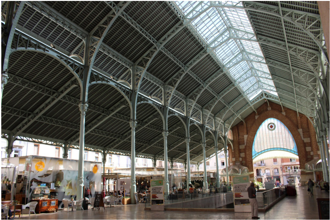
Figura 3. Estructura metálica del mercado de Colón, de Francisco Mora, en 1913, Valencia. Fuente propia de los autores.
