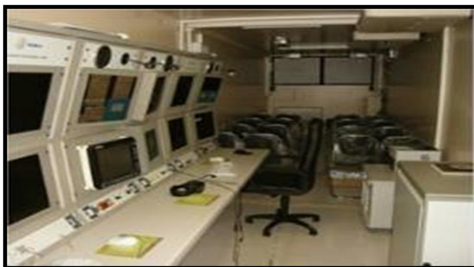
Figura N°21 - Vista Geral da Sala de Controlo do SPT
