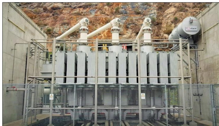
Figura 9. Transformador de Potência Shell
