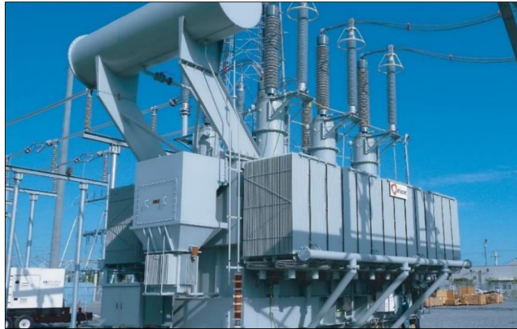
Figura 10. Transformador de Potência Core
