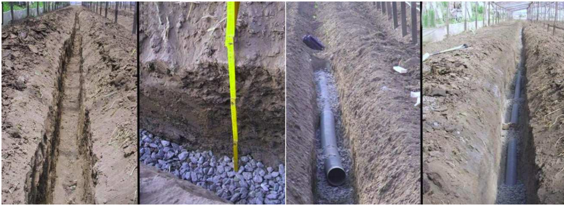
Figura 14 Drenes instalados en campo de productor
