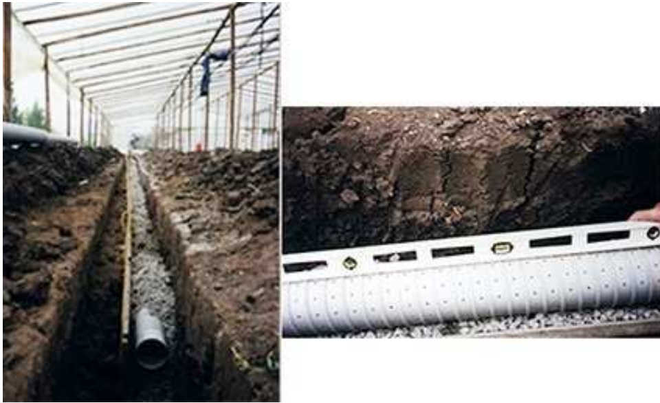
Figura 12 Drenes instalados en la EE Gorina subsuperficialmente sobre el techo del horizonte Bt, cobertura con piedra granítica (izquierda) y uso de nivel para mantener pendiente (derecha)
