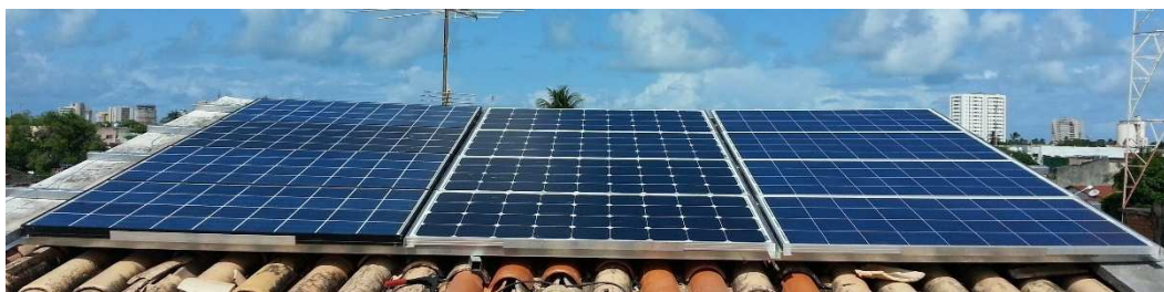
Fig. 1 - SFCR instalado no telhado de um escritório comercial com 1,6kWp potência total.
