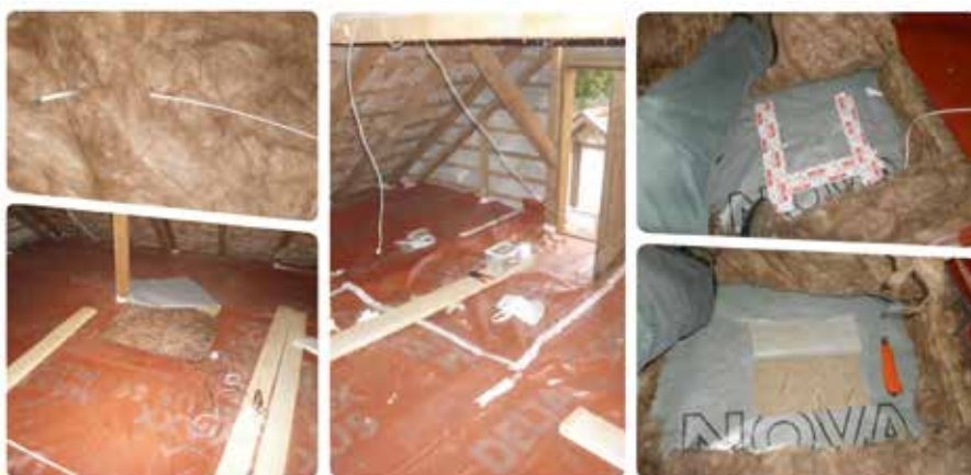
2. ábra: Higrotermikus monitoring rendszer kialakítása a hajdúnánási hőszigetelt családi ház padlásfödémének hőszigetelésében
