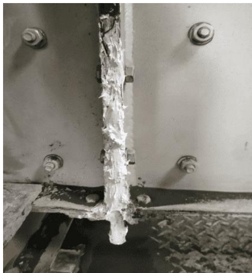
Gambar 6. Penambalan casing mesin chain scraper menggunakan silikon
