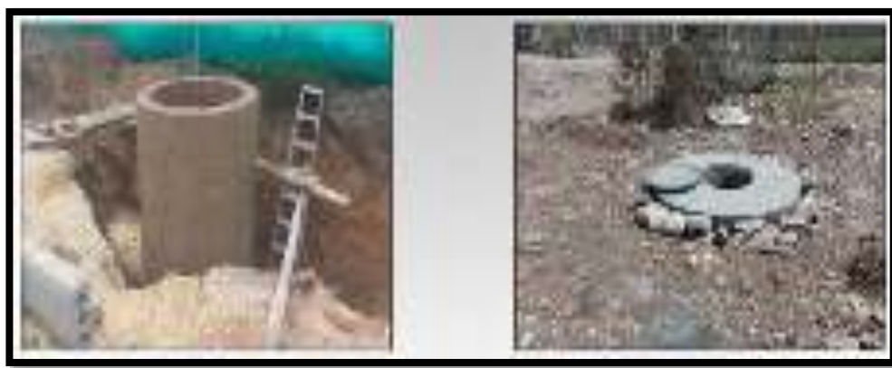
Figura 4.35: Buzones de drenaje pluvial
