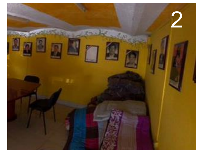
Fig. 57. Desprendimiento de repello en sala de cabildo (Eduardo Barroso, 2020).
