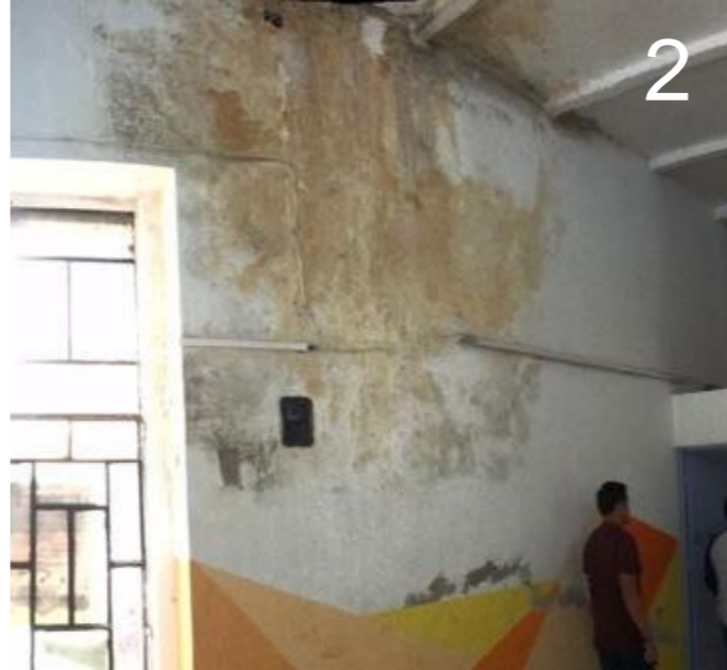
Fig. 59. Humedad en zona de talleres en salón de usos múltiples (Eduardo Barroso, 2020).
