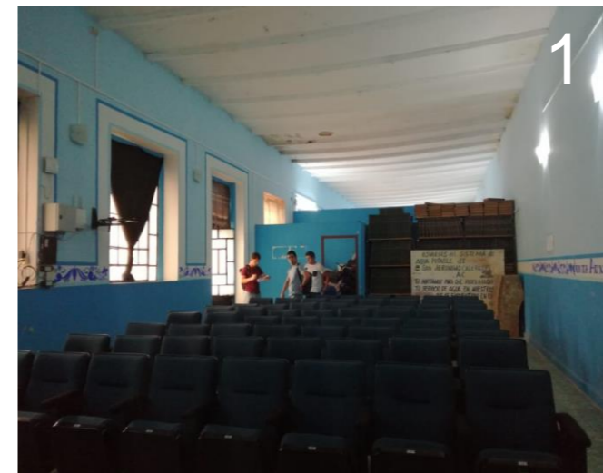
Fig. 56. Desprendimiento de repello en zona superior en sala de usos múltiples (Eduardo Barroso, 2020).
