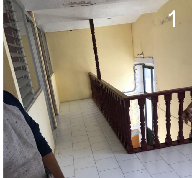
Fig. 58. Desprendimiento de repello en zona de oficinas de presidencia (Eduardo Barroso, 2020).
