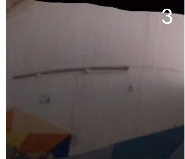
Fig. 60. Desprendimiento de repello en zona de talleres de salón de usos múltiples (Eduardo Barroso, 2020).
