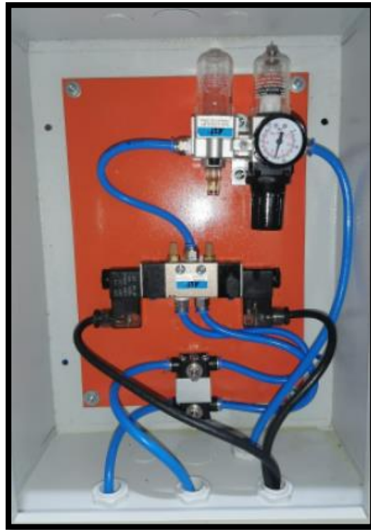
Figura 36 Tablero de control neumático
