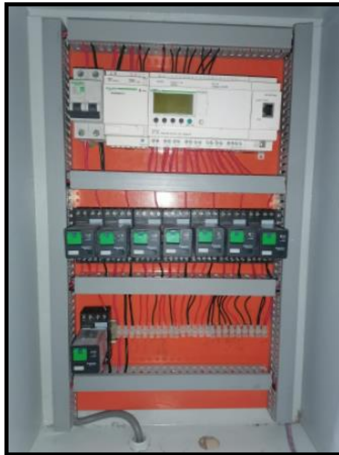
Figura 35 Tablero de control principal del sistema
