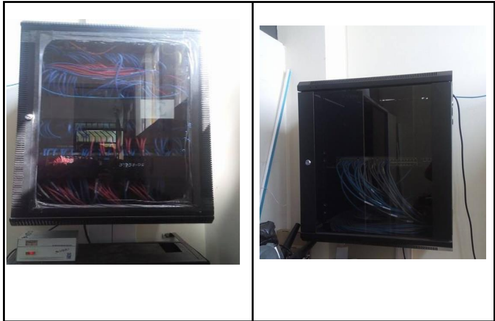
Figura 30: Switches ubicados en el gabinete (Laboratorio 01)
