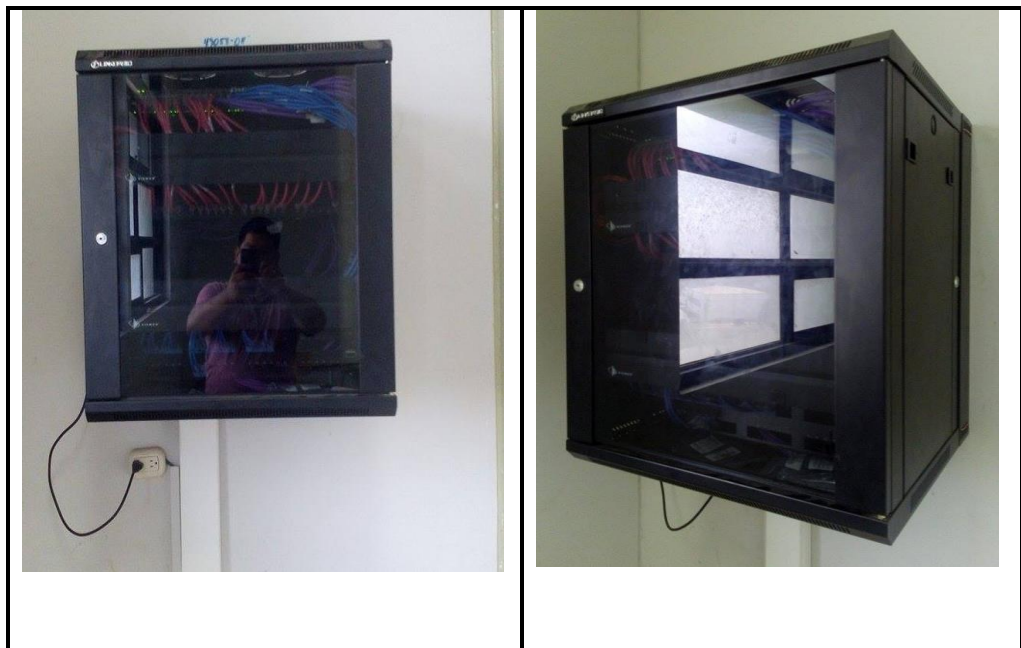
Figura 31: Switches ubicados en el gabinete (Laboratorio 05)
