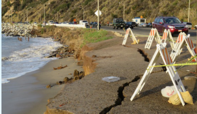
Los Angeles (erosion, 2016)
