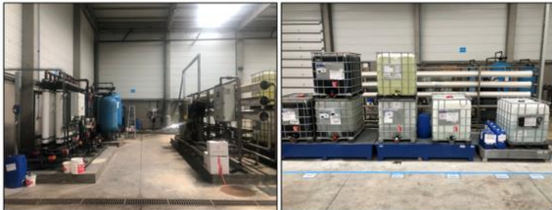
Figura 1 – Estação de Tratamento de Águas (ETA)
