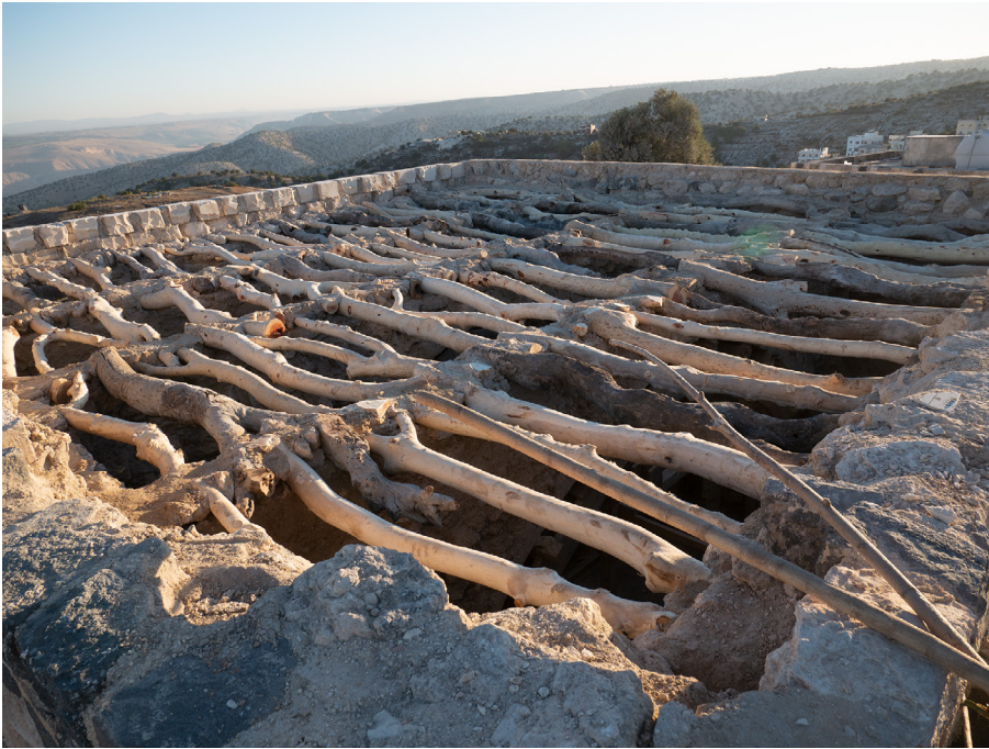
7 Umm Qays/Hara Foqa, Jordanien. Bauwerkserhaltung als Trainingsprogramm. Bauprozess der Dachkonstruktion – Aufbringen der Tamariskenstämme, Oktober 2021. (Foto: Olga Zenker)
