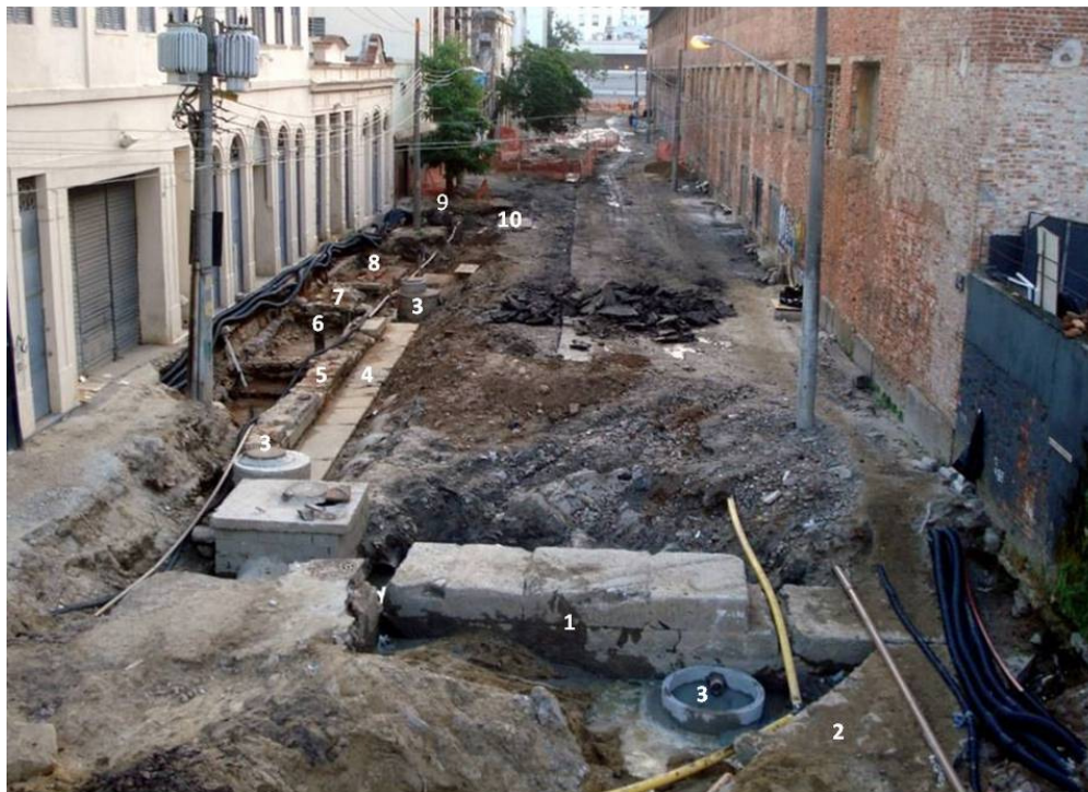
Figura 22 – Rua Coelho e Castro, escavações arqueológicas em andamento. (1) O primeiro píer encontrado; (2) o segundo píer, oblíquo, ainda em processo de escavação; (3) poços de visita recentes; (4) cais de atracação; (5) estrutura de apoio; (6) esteios remanescentes de tabuados; (7) área de transição; (8) trapiche 1; (9) trapiche 2; (10) terceiro píer. À direita, o edifício monumental das Docas D. Pedro II que bloqueou o acesso dos trapiches ao mar. Ao fundo, o Cais do Valongo. Fonte: Studio Soma.
