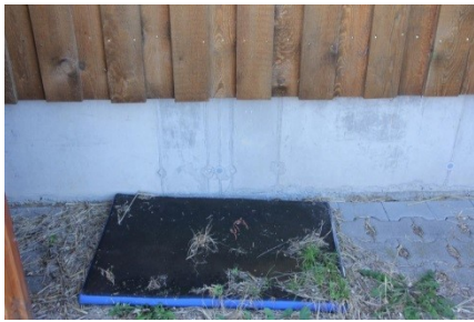
Abbildung 15: Beispiel für die nicht vorhandene Funktionstüchtigkeit der Desinfektionseinrichtungen für Schuhwerk
