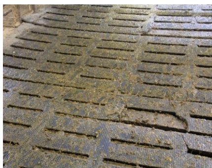
Abbildung 69: Defekte Stellen im Spaltenboden
