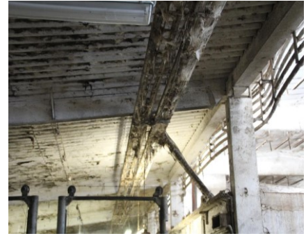
Abbildung 25: Verschmutzte Decken und Kabel im Laufgang
