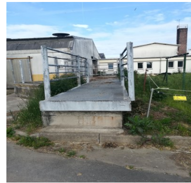
Abbildung 38: Verladerampen im Außenbereich, keine ausreichende Abgrenzung zum Innenbereich der Anlage (Foto: Waade, 2019)
