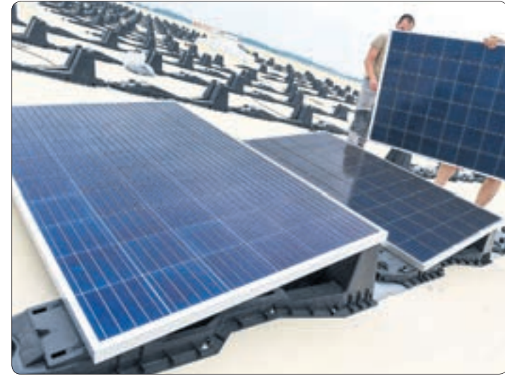
Solarstrom frei Haus: Fotovoltaikanlagen versprechen etwa auf Flachdächern eine reiche Energieernte. Foto: djd/Paul Bauder
