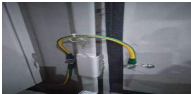
Gambar 4.2. Kabel penghantar grounding
