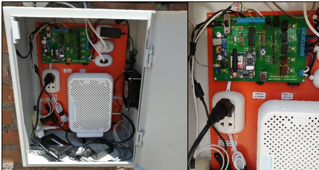
Figura 48. Sistema final implementado en el gabinete de la antena microondas
