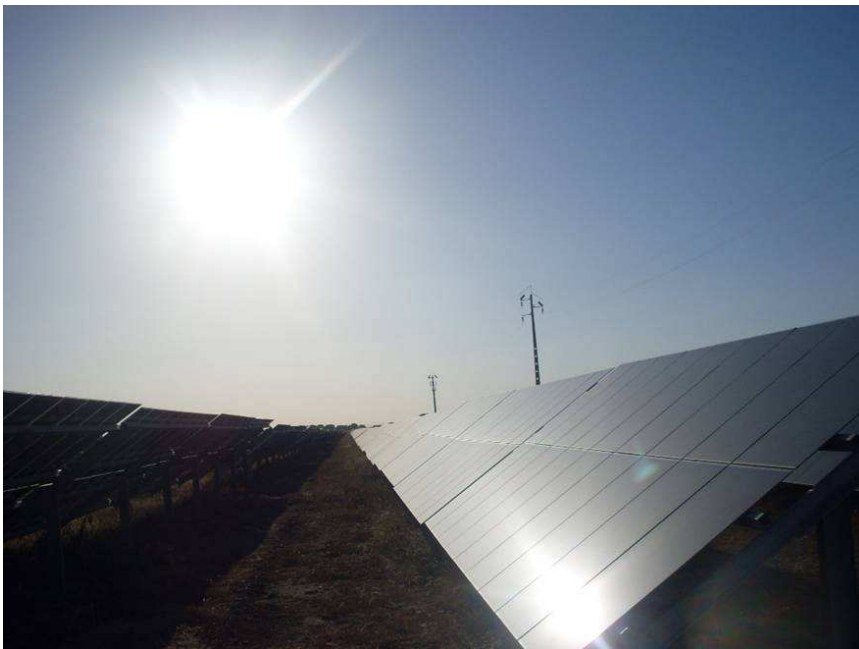
Ferreira do Alentejo PV power plant (Picture:Inês Almeida)
