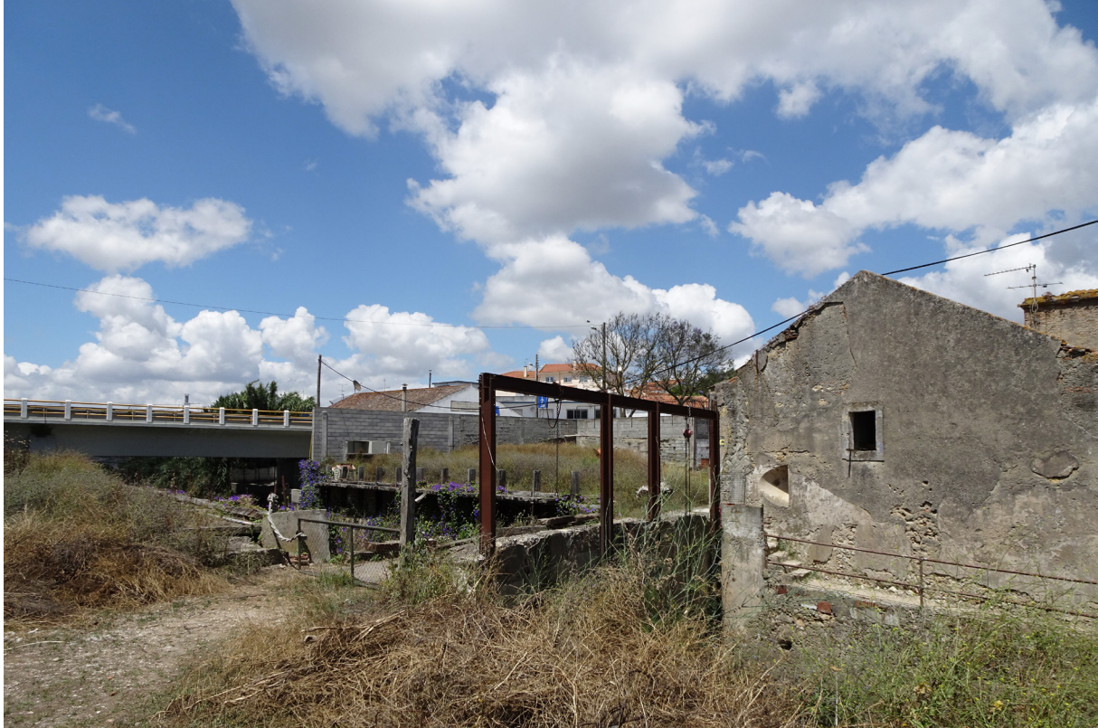
Figura 65 – Sistema de controlo de caudal no rio Ota, Vila Nova da Rainha, 2018
