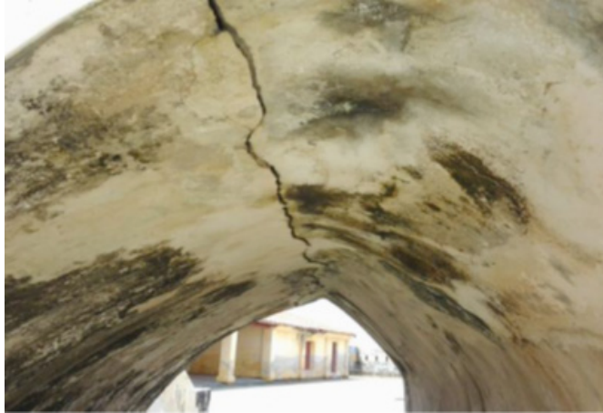
Figura 5 – Rampa, grieta transversal a lo ancho de la rampa de un espesor de hasta 1
