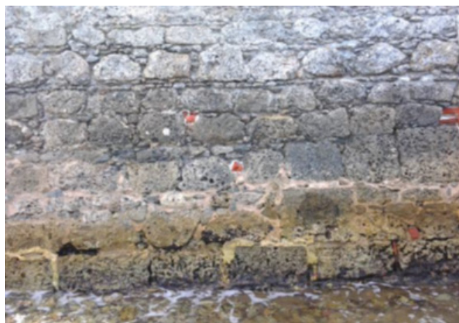
Figura 4 – Escarpa tronera, presencia de alveolos profundos entre 1cm y 2cm, pérdida de sillares, inexistencia de juntas, humedad, fracturación de material pétreo
