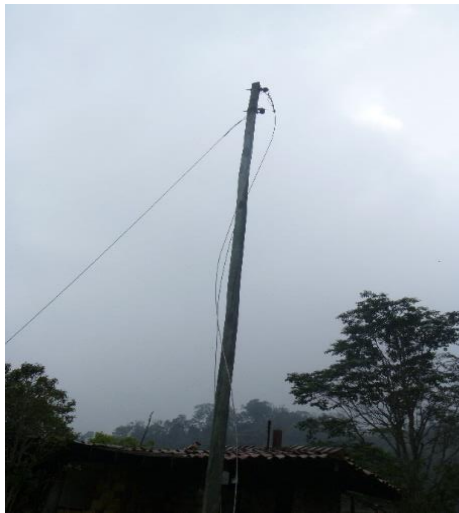
Ilustración 7. Punto de suministro de energía eléctrica- predio Marbella II.
