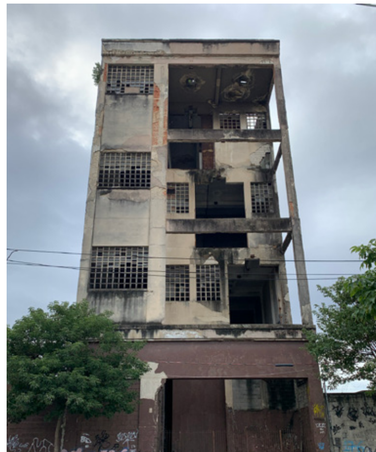
Edifício em ruínas, Santo Cristo, RJ. Acervo pessoal, 2021.
