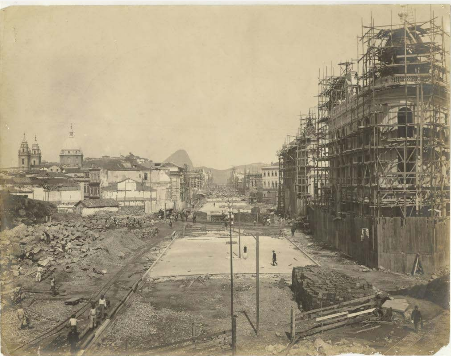
Figura 03 – Obras para abertura da Avenida Central, 1905, por Augusto Malta Fonte: Brasileira Fotográfica, acervo Museu da República
