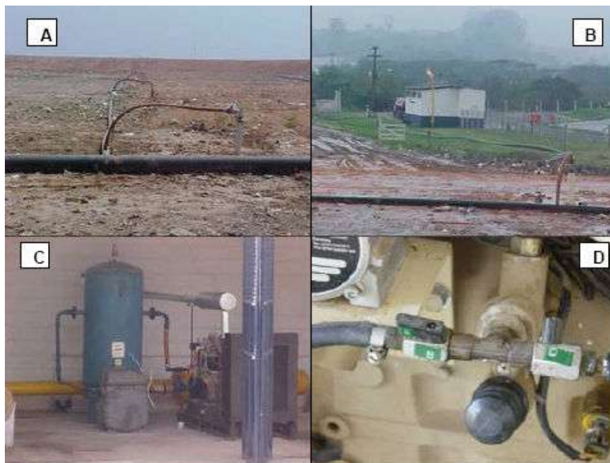
A - Coleta dos gases sem sucção; B - Linha de abastecimento da Central; C - Gerador de energia elétrica; D - Válvula de controle
