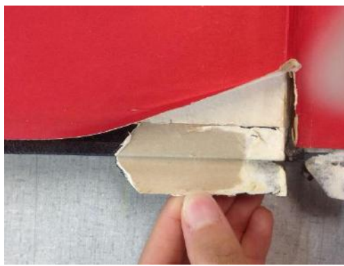
FIGURA 38- Parte da virada do revestimento solta. Fonte: fotografia da autora, 2017.
