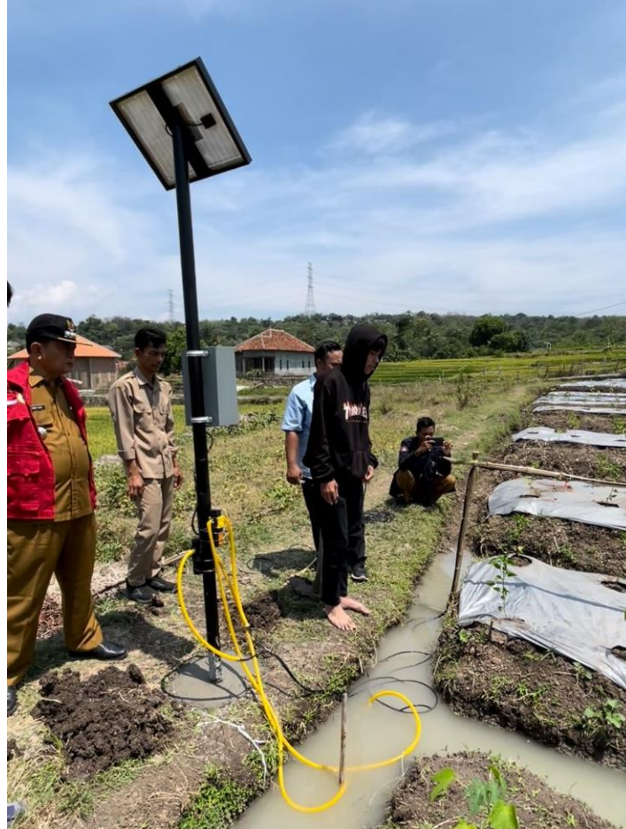
Figure 7. Lokasi Pemasangan Alat
