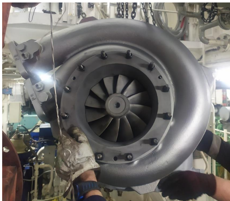
Fig. 2.6.2.3.1: Instalación de un turbocompresor radial ABB de doble entrada en un motor Wärtsilä 6L26A. (Fotografía propia)
