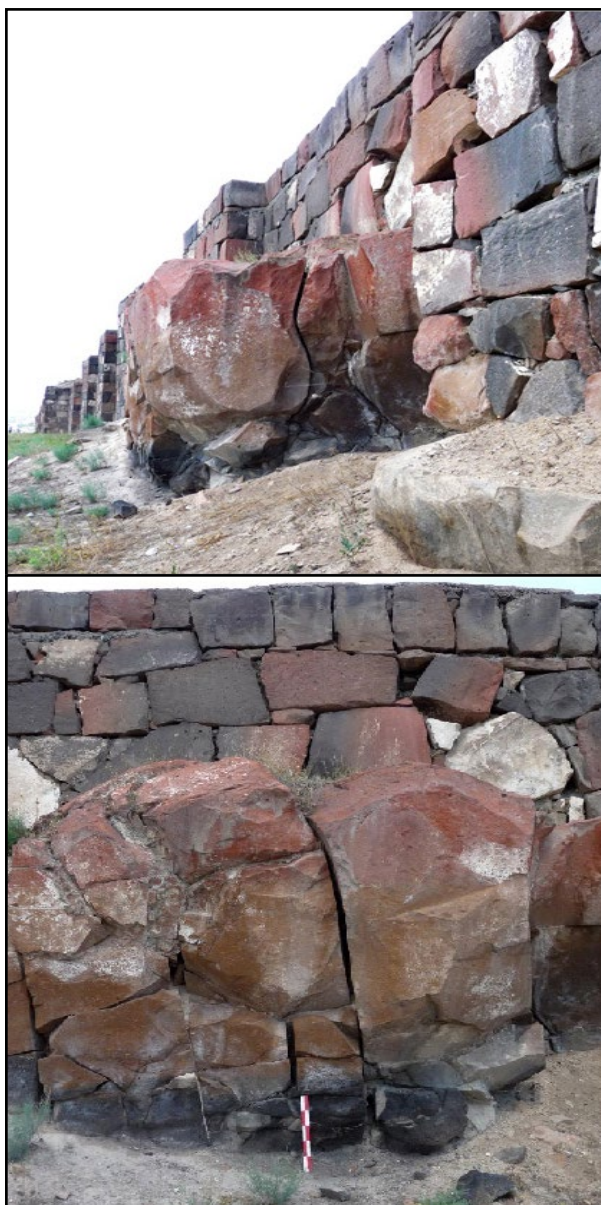
Figure 8. Rocher fracturé auprès de la première porte bouchée de la forteresse (séisme 1) (photo B. Helly, CNRS).
