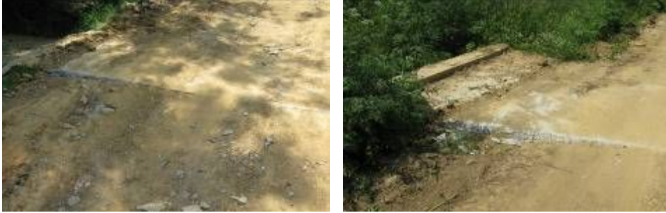
Şekil 3: Sanat yapılarının üst kesimlerinde meydana gelen deformasyonlar
