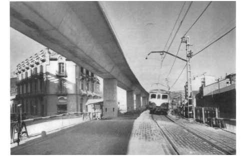
Fig. 6 Imatge de la construcció del viaducte en un dels passos a nivell
