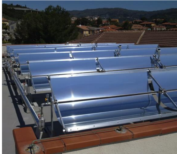
Figura 14. Campo solar con colectores Solar Wing EVO (Trivelli Energia, 2015).
