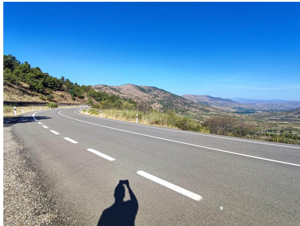
Ilustración 15. Tramos sin defensas laterales considerando que la carretera se encuentra a una altura elevada y en una ladera.
