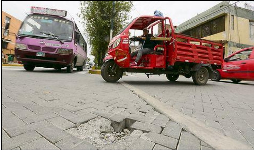
Figura 6: Fallas en pavimentos adoquinados. Fuente: Condori (2019).
