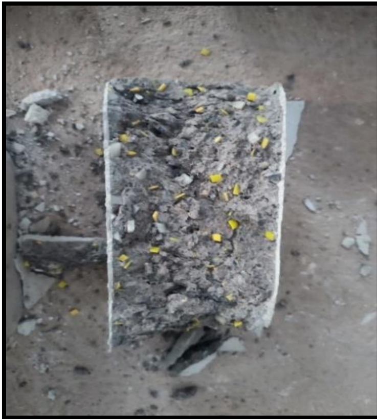
Fotografía 39. Vista del adoquín roturado.
