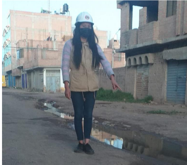
Figura 1. Fallas presenciadas en el Jirón Cuzco, intersección Jirón Carlos Mariátegui Fuente. Elaboración propia
