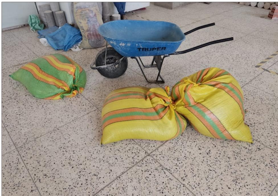
FOTOGRAFIA 02.- SE OBSERVA EL TRASLADO DE AGREGADO EN BOLSAS HERMETICAS Y SACOS PARA QUE ESTE NO PIERDA EL CONTENIDO DE HUMEDAD
