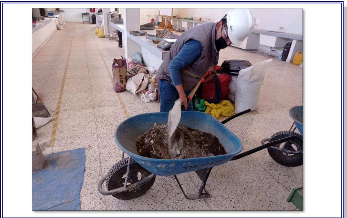
FOTOGRAFIA 08.- SE OBSERVA EL MEZCLADO Y PREPARADO DEL CONCRETO PARA LA ELABORACION DE ESPECIMENES
