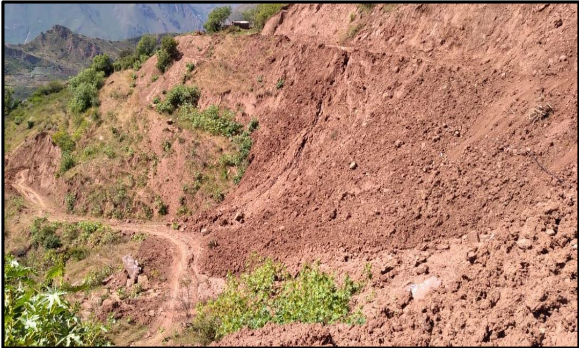
Figura 2: Mal estado que se encuentra inicio de los ensayos.
