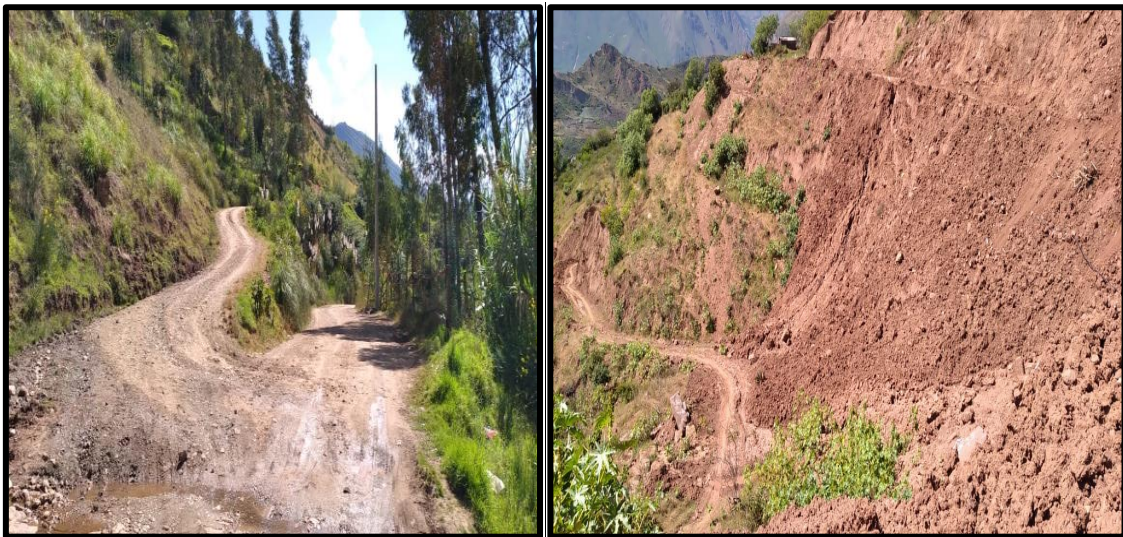
Fuente: trochas en mal estado.
