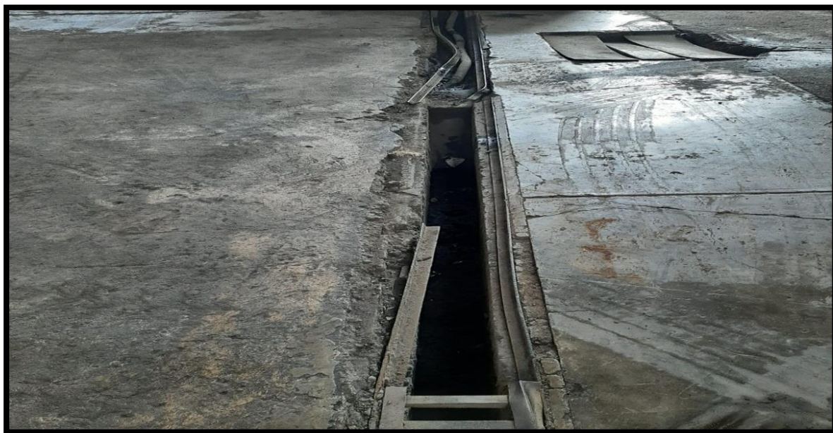
Figura N° 10: Foto de evidencia de la falta de mantenimiento del piso en la base de la flota terrestre
