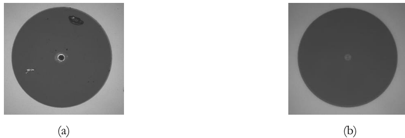
Figura 2.23. Vista frontal de conectores tipo FC/APC: (a) daño en el núcleo de un conector; (b) conector sin impurezas según la norma IEC 61300-3-35.
