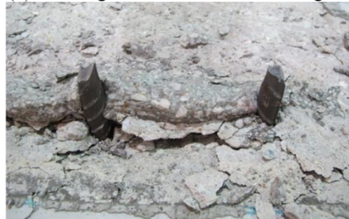
(d) Fracture of column reinforcement
