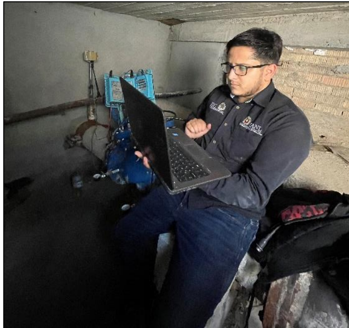
Figura 4-22 Programación de válvula modulante para efectuar prueba de presión.
