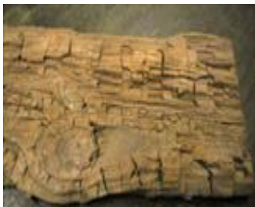
Figura 13: Evidências da ação dos fungos basidiomicetos ( Brown rot ) na madeira (Henriques, 2011, p. 39).
