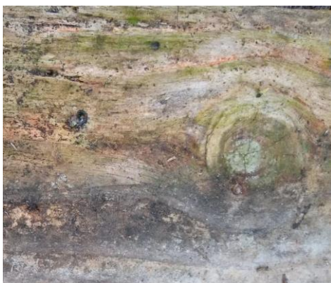
Figura 12: Evidências de manchas de colônias de fungo cromogéneo na superfície da madeira. © Rita Doria.
